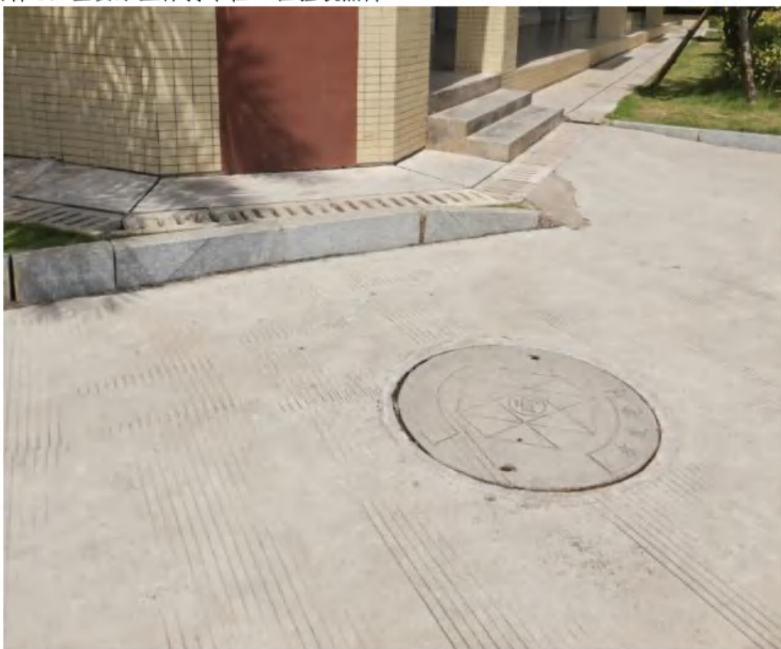
建筑物防治区排水明沟、雨水井（2022年11月）
