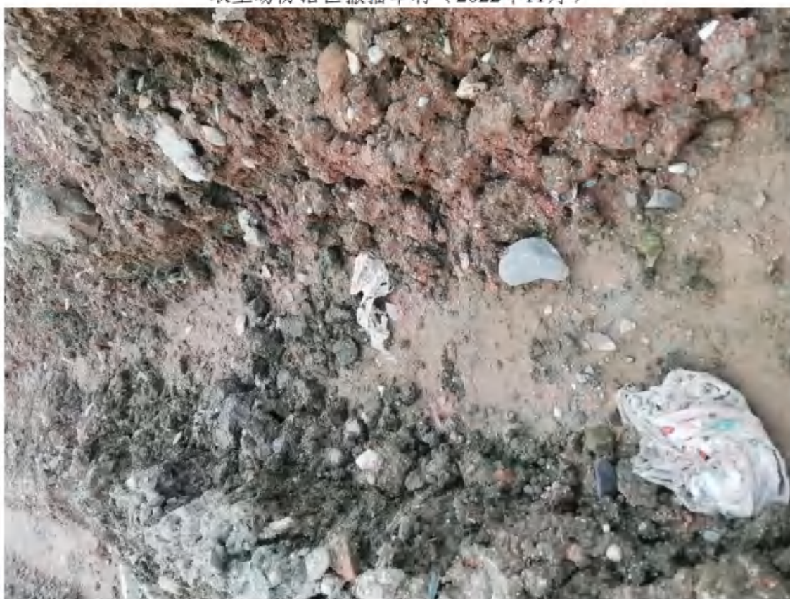
取土场防治区土质排水沟（2022年11月）
