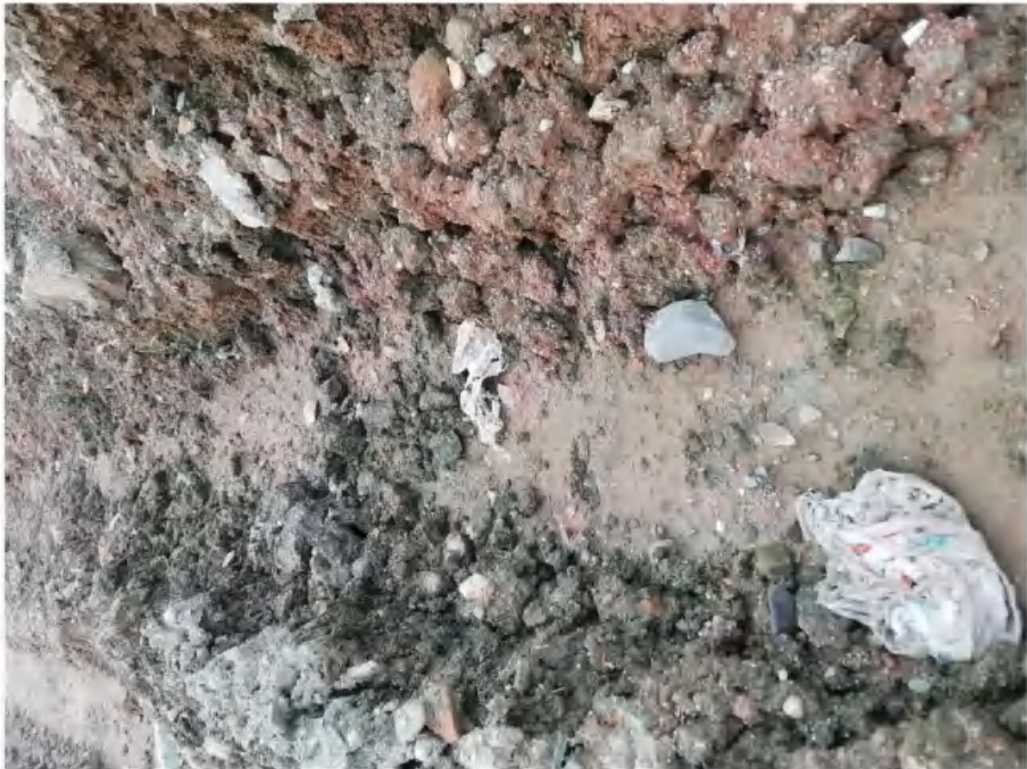
取土场防治区土质排水沟（2022年11月）
