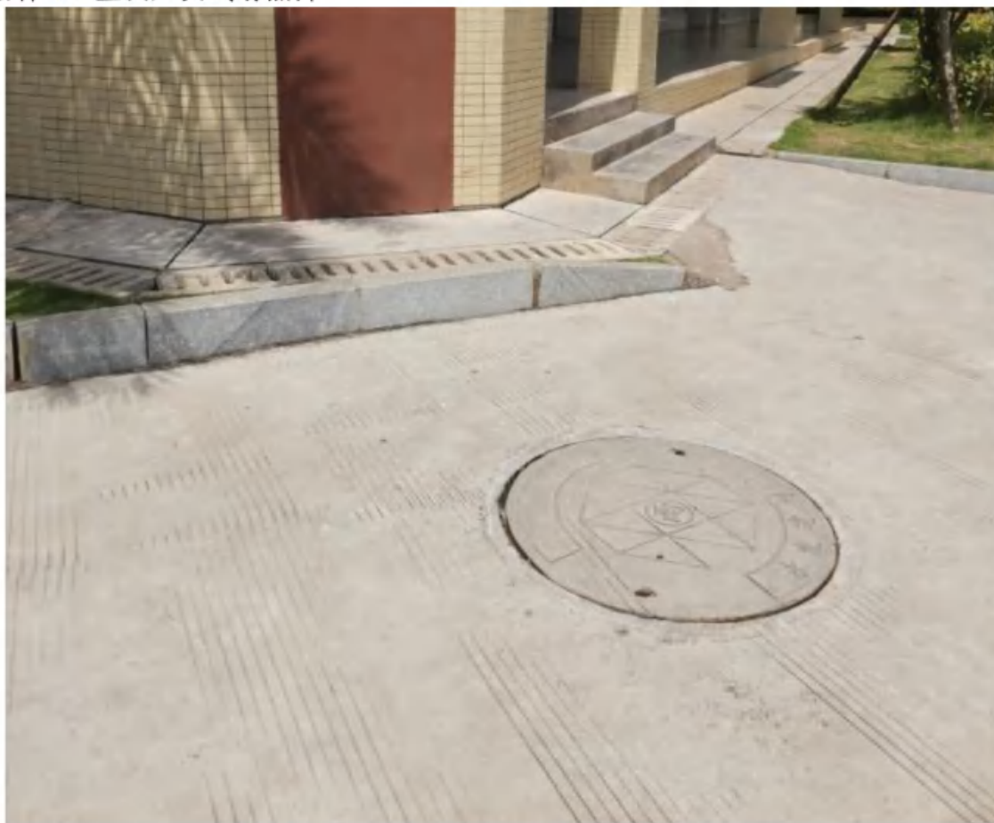
建筑物防治区排水明沟、雨水井（2022年11月）
