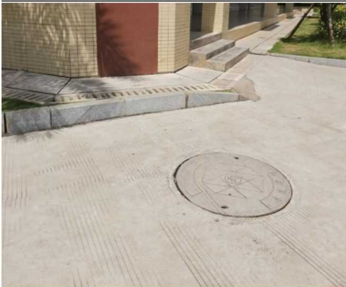
建筑物防治区排水明沟、雨水井（2022年11月）
