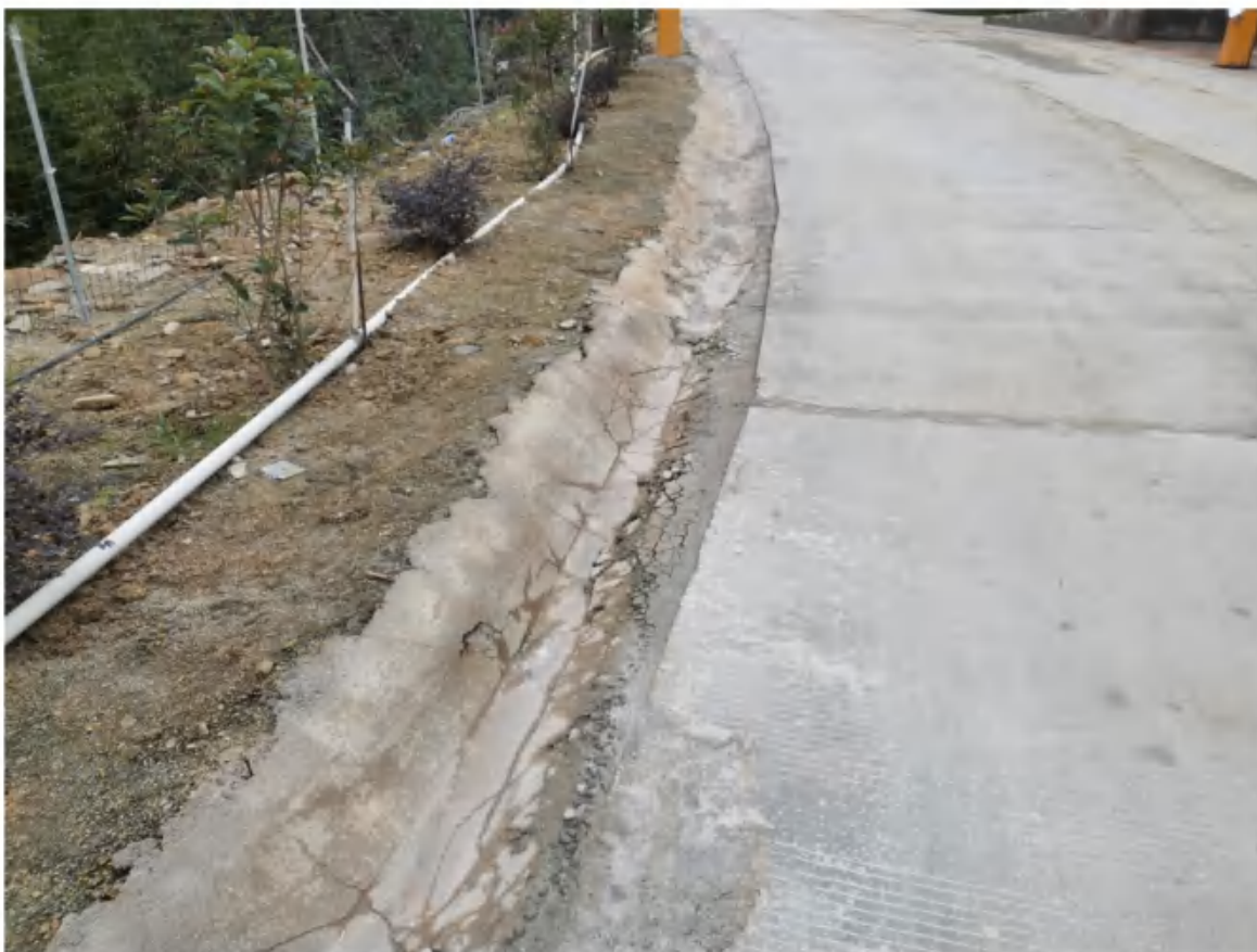
矿山道路区排水设施
